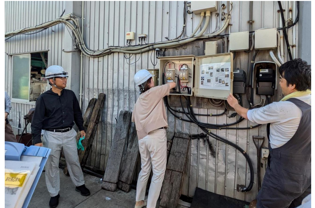
発電機からの電力供給に切り替える訓練の様子
